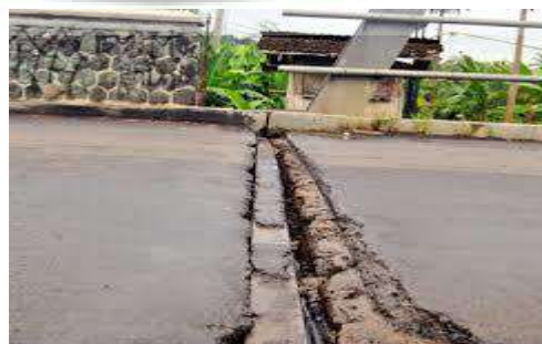
Gambar 2.4 Retak Sambungan Jalan Sumber : Sukirman (1999)
